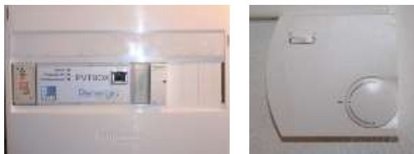
Figure 7 : Installation du régulateur dans le tableau électrique ; vue du pupitre de commande : le bouton de réglage permet d'ajuster la température de consigne aux besoins ; un interrupteur permet de couper le chauffage principal
