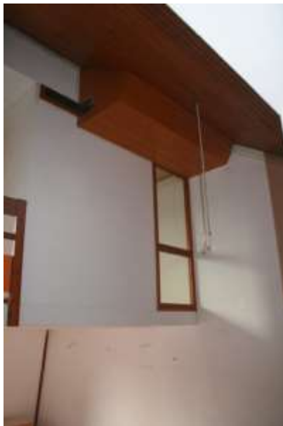
Figure 4 : Insufflation de l'air dans la zone principale
