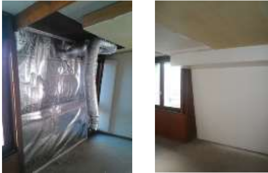
Figure 3 : Système d'insufflation de l'air chaud avant et après installation dans le plenum
