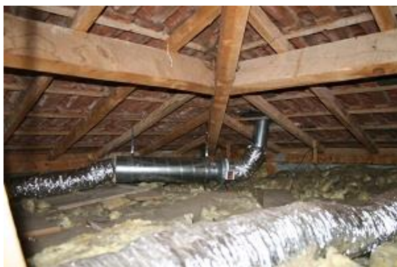
Figure 3 : Installation des tuyaux véhiculant l'air dans les combles; le ventilateur et le silencieux sont suspendus pour éviter de transmettre des vibrations à la structure de l'habitation
